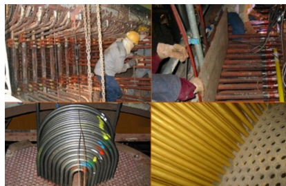
Ремонт на котелската постројка (Напоен резервоар, загревачките, испарувачките и прегревачките цевни снопови и др.)
