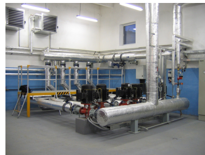
Сл. 5.5.14. Пумпна станица со повеќестепени пумпи
