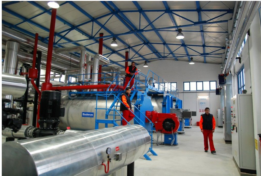
Слика 18. Котларска постројка
